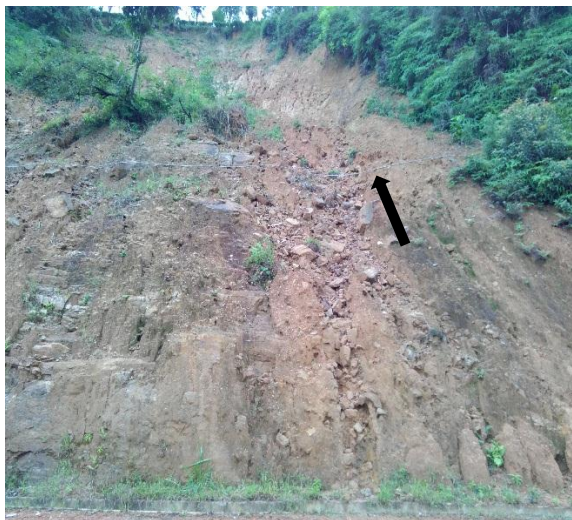
රූපය c: ඉහල බෑවුමේ අස්ථාවර වූ ප්‍රදේශය හරහා වැටී ඇති ජල සැපයුම් නලය
