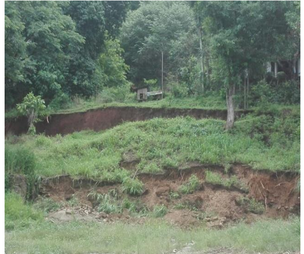
රූපය 2b: බස් නැවතුමේ පසුපස මායිමෙහි ඇති අස්ථාවර බෑවුම
