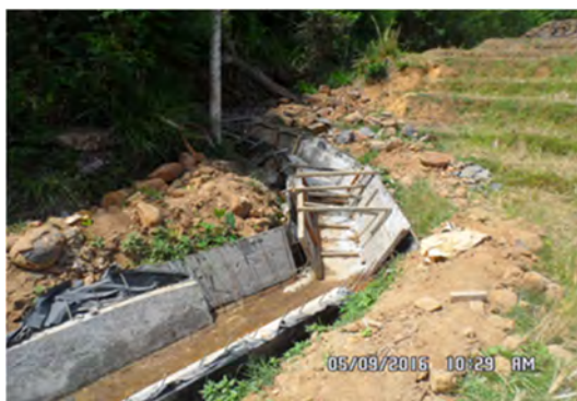
Unnatural linear ditch line
